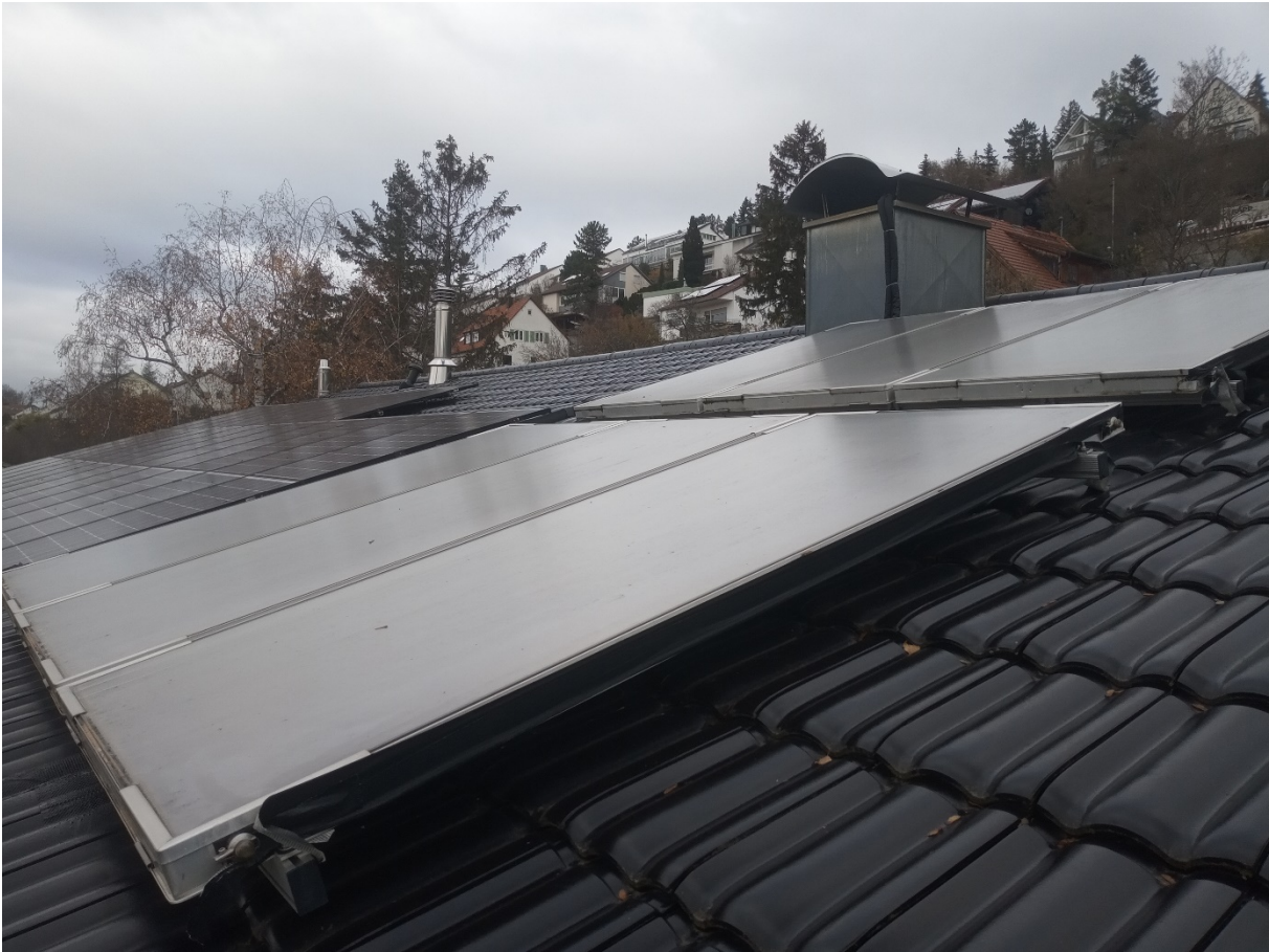
Abbildung 4-4: Sonnenkollektoren der Feldtestanlage LoK
