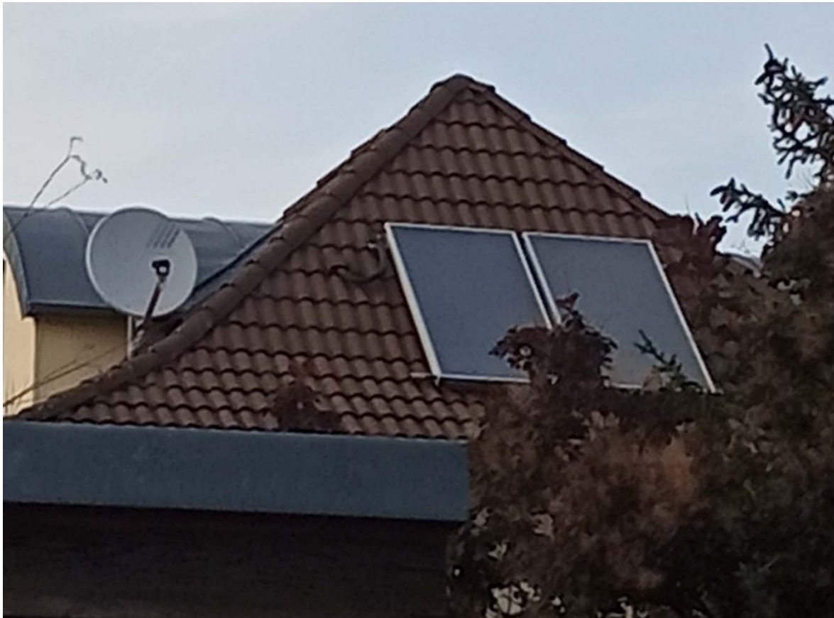
Abbildung 4-6: Sonnenkollektoren der Feldtestanlage LoT
